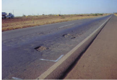
Repavimentación sin geotextile
