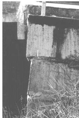
Desplazamiento de elementos de la face
