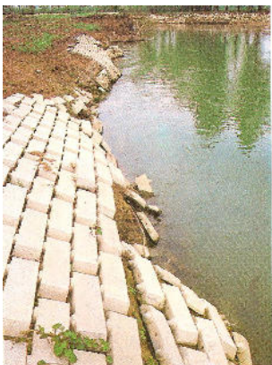
Daños por velocidad de flujo elevada y/o ausencia del filtro subyacente
